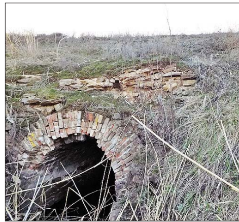
Туннель для водоотведения на станции «Власовские копи».
