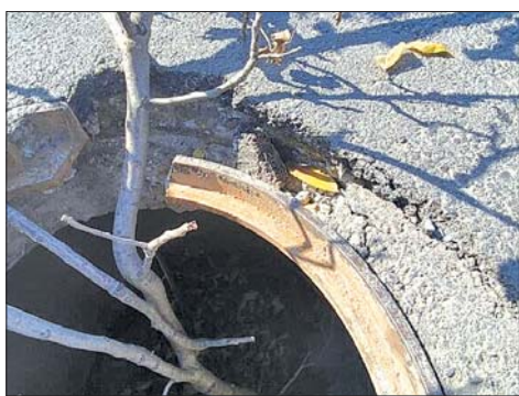
Открытый люк и трещина на асфальте появились на отремонтированной дороге.
