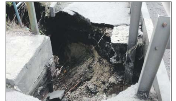
Мост через реку Грушевку разрушается не впервые.
