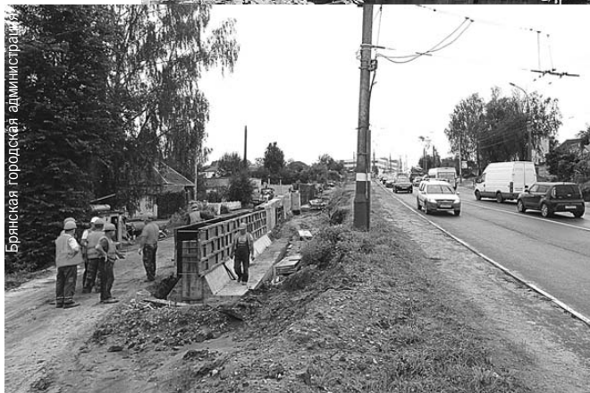
Подпорная стена защитит жителей ближайших к Городищенской горке домов от сползания грунта с дороги.
