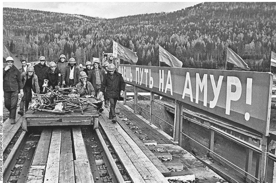
50 лет назад, в основные годы строительства БАМа, было проложено около 3 тысяч км пути.
