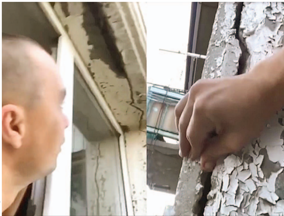
В одной из квартир в Ново-Ленино появилась трещина у окна.
