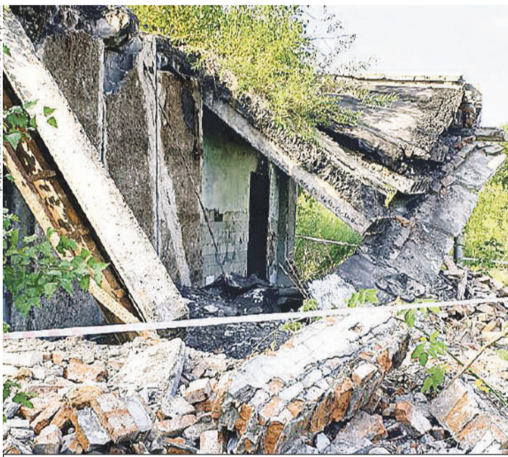
Плиты рухнули в старом кирпичном здании.
