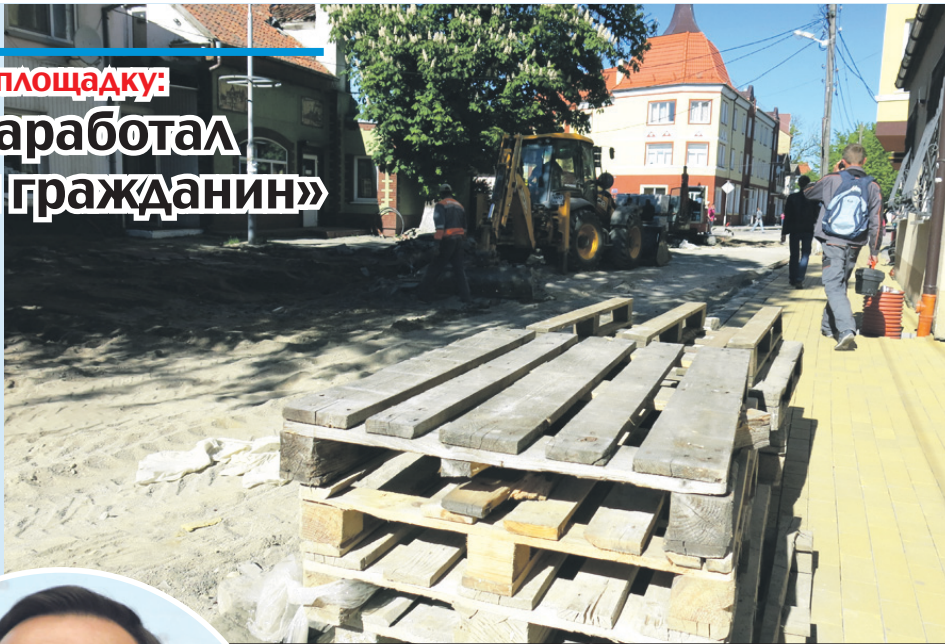
Жители муниципалитетов, например, могут выбрать, какие тротуары стоит отремонтировать в этом году. На фото - благоустройство в центре Зеленоградска.
