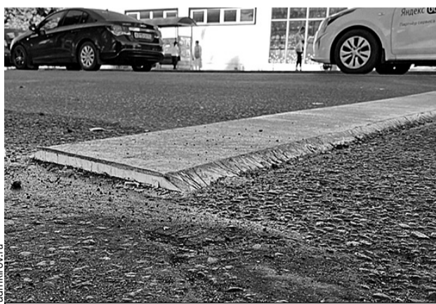
Нарушения стандартов нашли на Октябрьском проспекте и у дома №17 по улице Лепсе.
