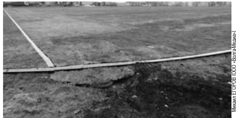
Ливневки не работают, на поле - лужи и грязь.
