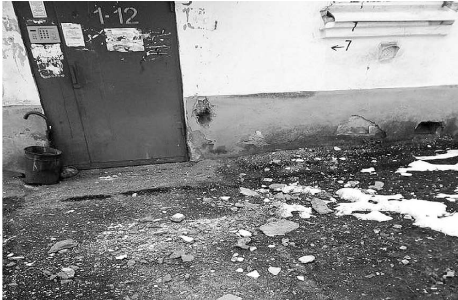
Пласт штукатурки упал рядом с детской коляской.
