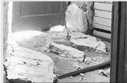
В подъезде рядом с выходом обвалился большой кусок штукатурки.
