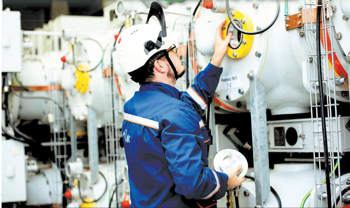
Осмотр контактной системы шинного разъединителя комплектного распределительного элегазового устройства.
