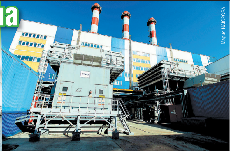
Газотурбинные установки для выработки электрической энергии.
