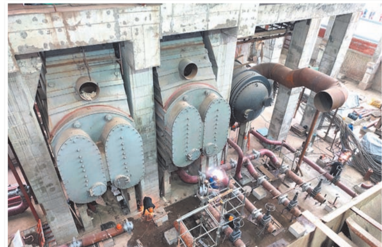
В результате модернизации электрическая мощность Владивостокской ТЭЦ-2 возрастет до 574 МВт, тепловая - до 1 115 Гкал/ч.
