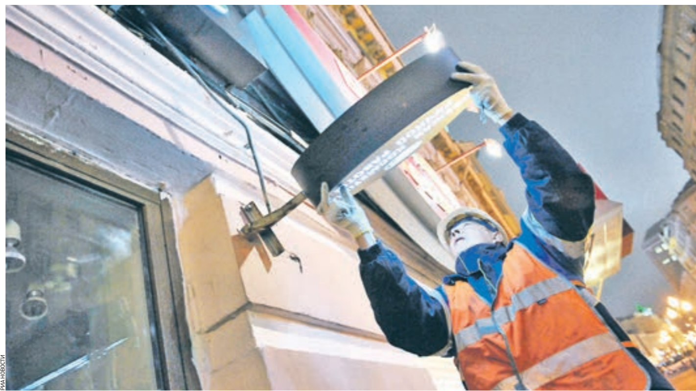
Демонтаж незаконных рекламных конструкций в столице будет продолжен и в следующем году. Совсем скоро городская реклама станет украшать улицы и площади, а не закрывать их
