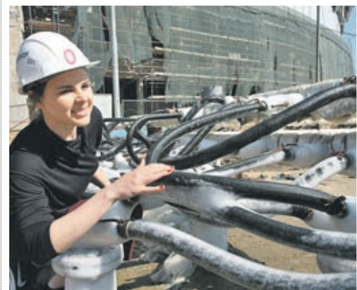
Вчера 13:20 Инженер Екатерина Комаровских изучает контур заморозки грунта на станции «Петровский парк»
