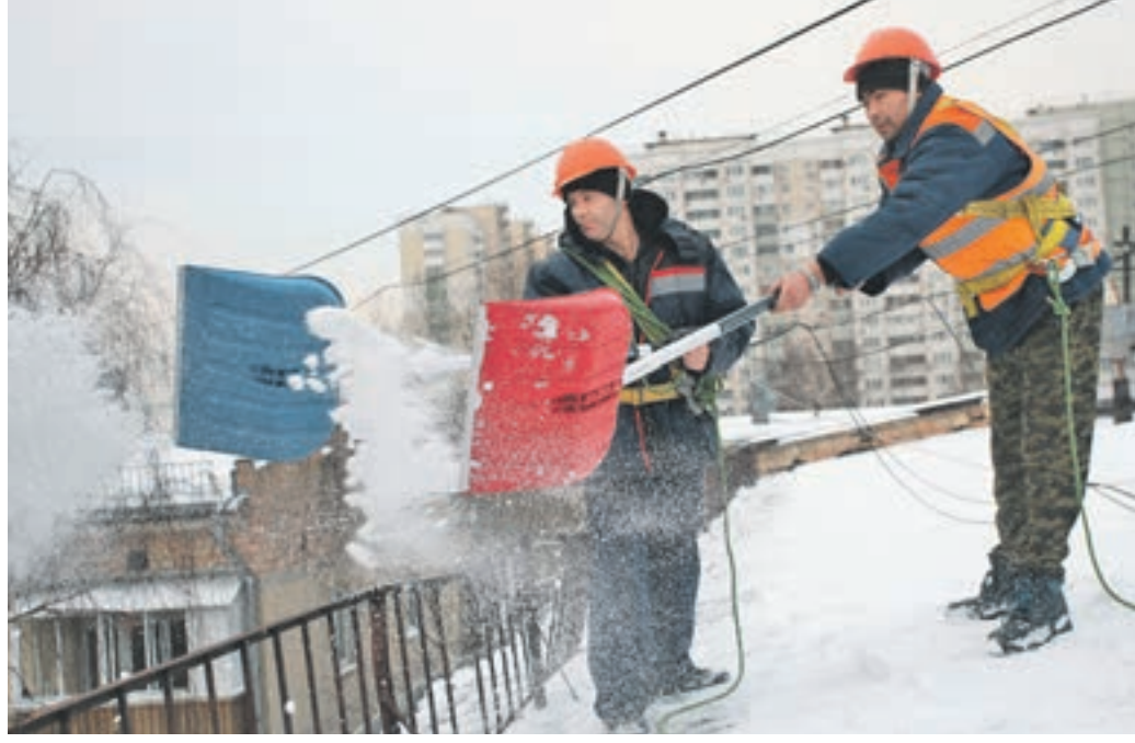
8 декабря 14:25 Бригадир кровельщиков Павел Истомин (слева) и помощник Евгений Анапов (справа) устраняют последствия снегопада на крыше дома № 124 на Волгоградском проспекте
