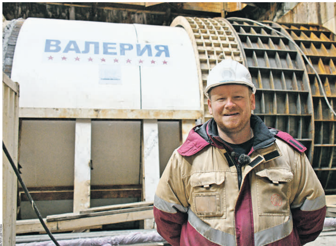
15 ноября 2018 года. Начальник участка Евгений Бибилов фотографируется на фоне проходческого щита «Валерия». Машине предстоит пройти от камеры съездов у Перовской нефтебазы в сторону станции «Авиамоторная» Большой кольцевой линии метро
