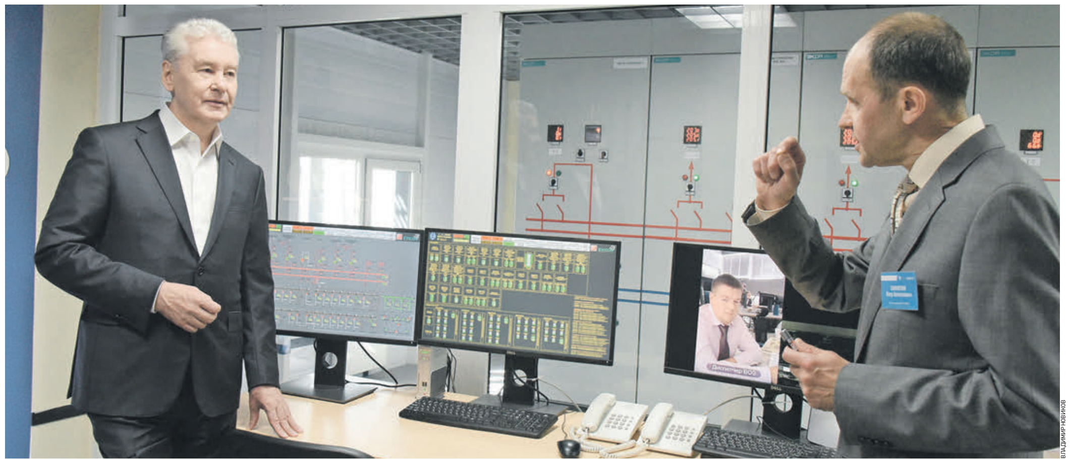
Вчера 14:45 Мэр Москвы Сергей Собянин (слева) посетил щит, где находится пульт управления электростанцией. Но, как рассказал главе города гендиректор МОЭСКА Петр Синютин (справа), как только закончится наладка, эта комната будет, по сути, резервной.
