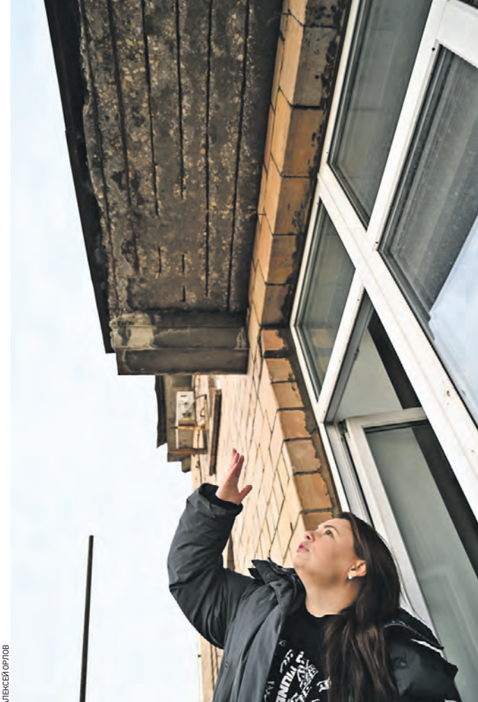
6 декабря 10:16 Жительница дома на улице Автозаводской Ольга Зиминова показывает состояние балкона над ее квартирой. Требуется накрепонт
