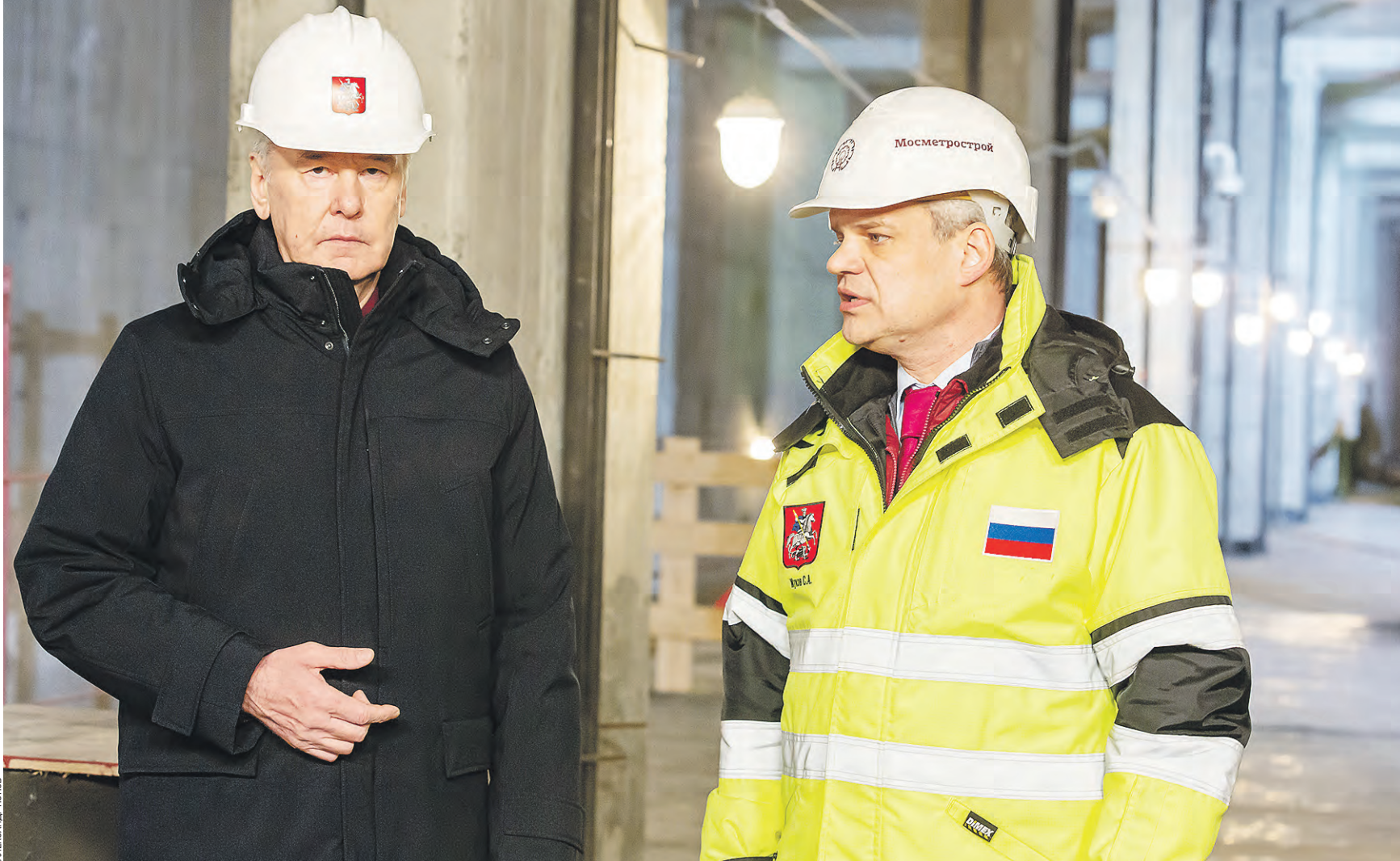
Вчера 13:13 Мэр Москвы Сергей Собянин (слева) и генеральный директор Мосметростроя Сергей Жуков осмотрели ход работ на строящейся станции «Лианозово» Люблинско-Дмитровской линии метро. Ее свяжут с первым Московским центральным диаметром
