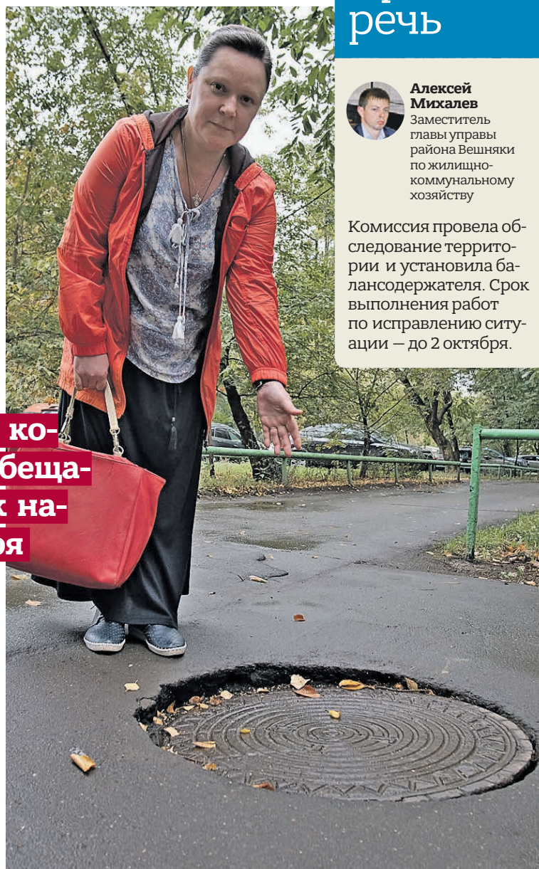
11 сентября 2018 года. Жительница района Вешняки Ольга Жилина показывает провалившийся канализационный люк
