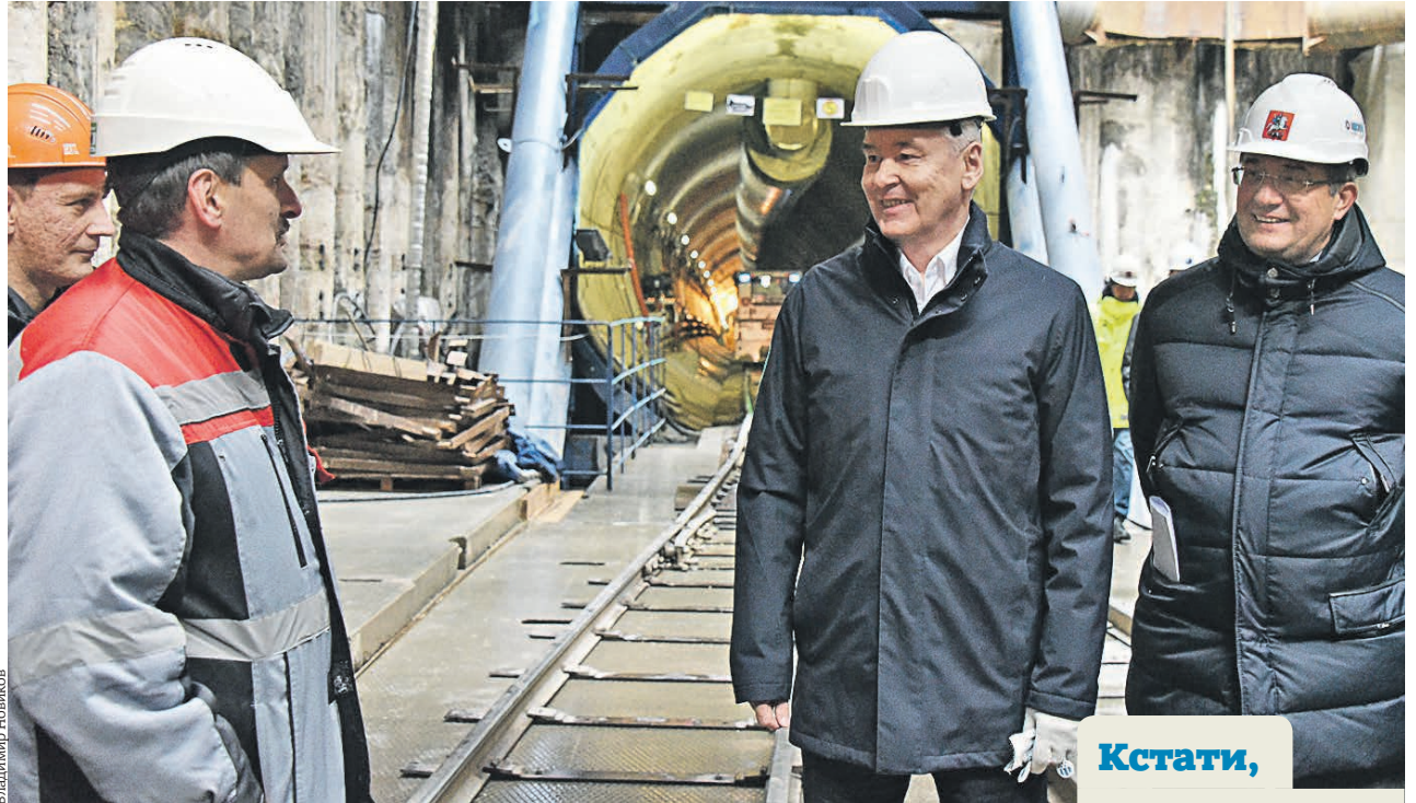
26 октября 2018 года. Начальник участка строительства Сергей Макаров, мэр Москвы Сергей Собянин и генеральный директор компании подрядчика Марс Газизуллин (слева направо) на стройке Большой кольцевой линии
