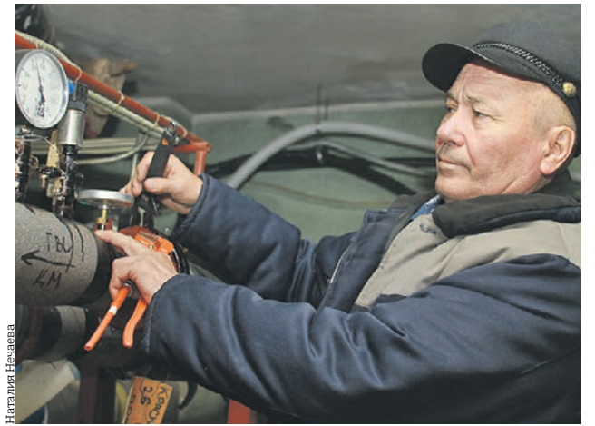
12 августа 2019 года. Специалист Константин Басыров проверяет оборудование перед отопительным сезоном
